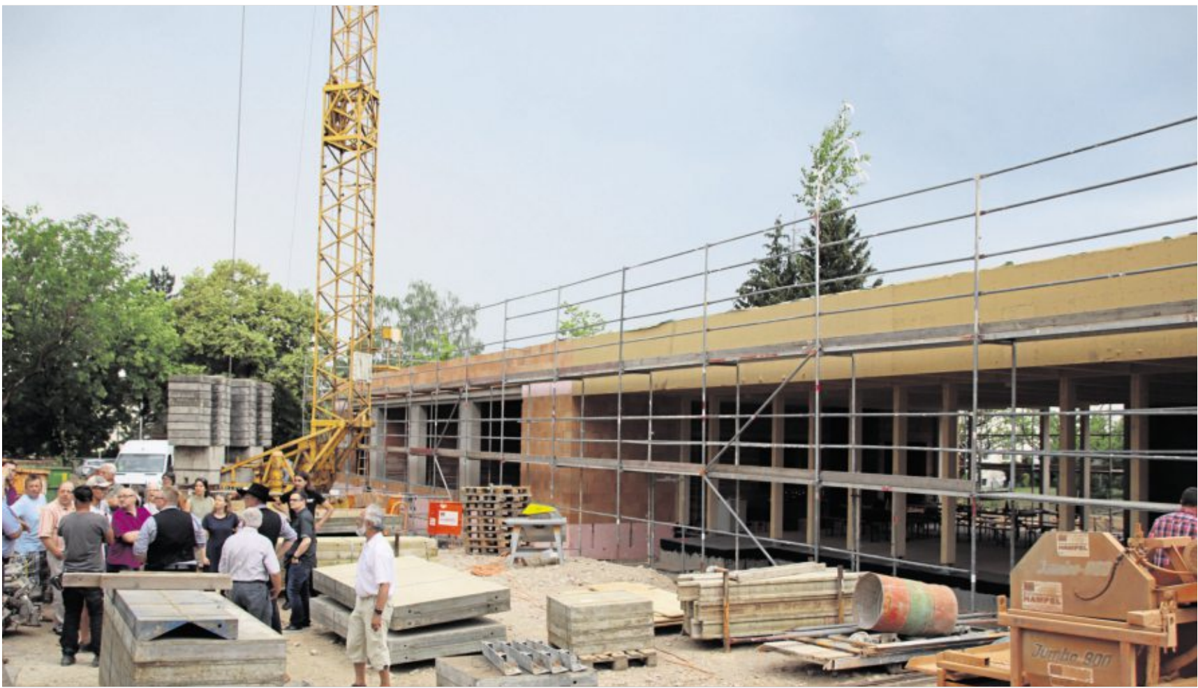
Mit Gästen aus Pfarrei und Kommunalpolitik feierten Bauherr Pfarrer Heinrich Rosner (vorne, rechts) und die Vertreter der ausführenden Firmen Richtfest am Flachbau des neuen Pfarrheims.
